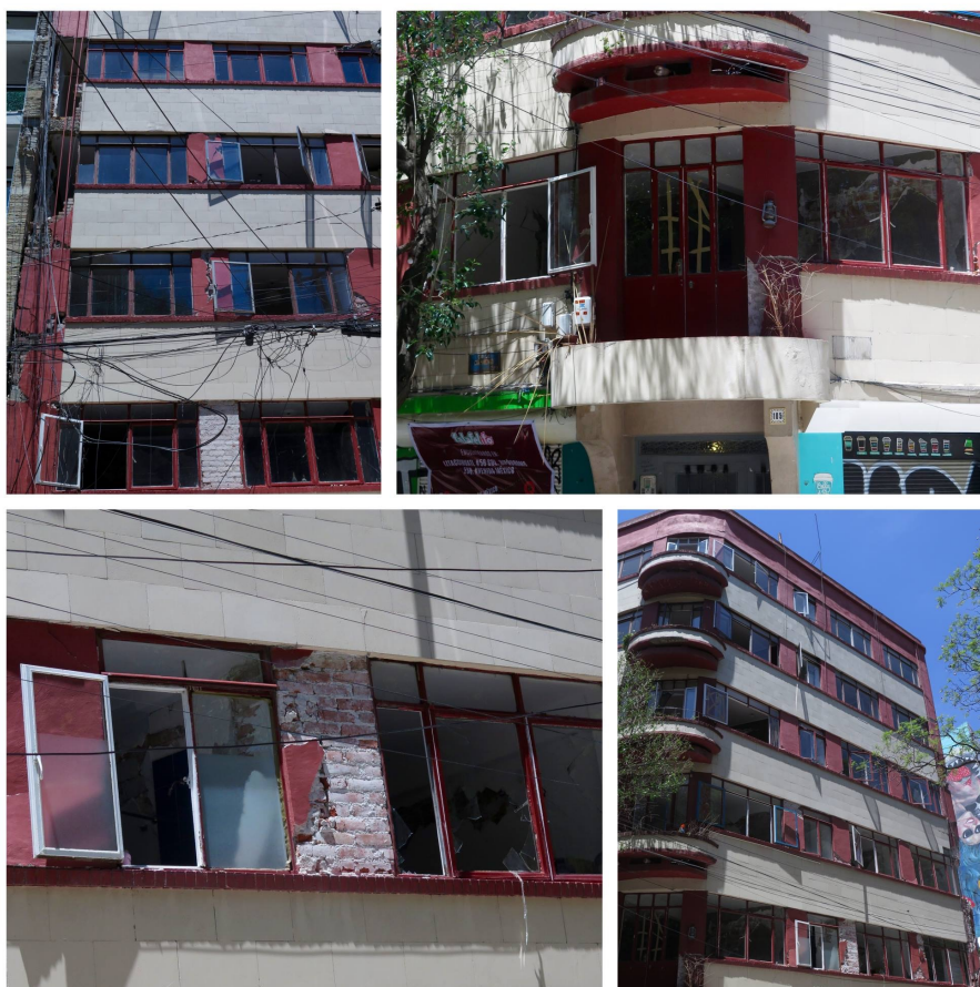
Photos d'un immeuble fortement endommagé dans le quartier central de Condesa, l'un des plus touchés par le tremblement de terre.
